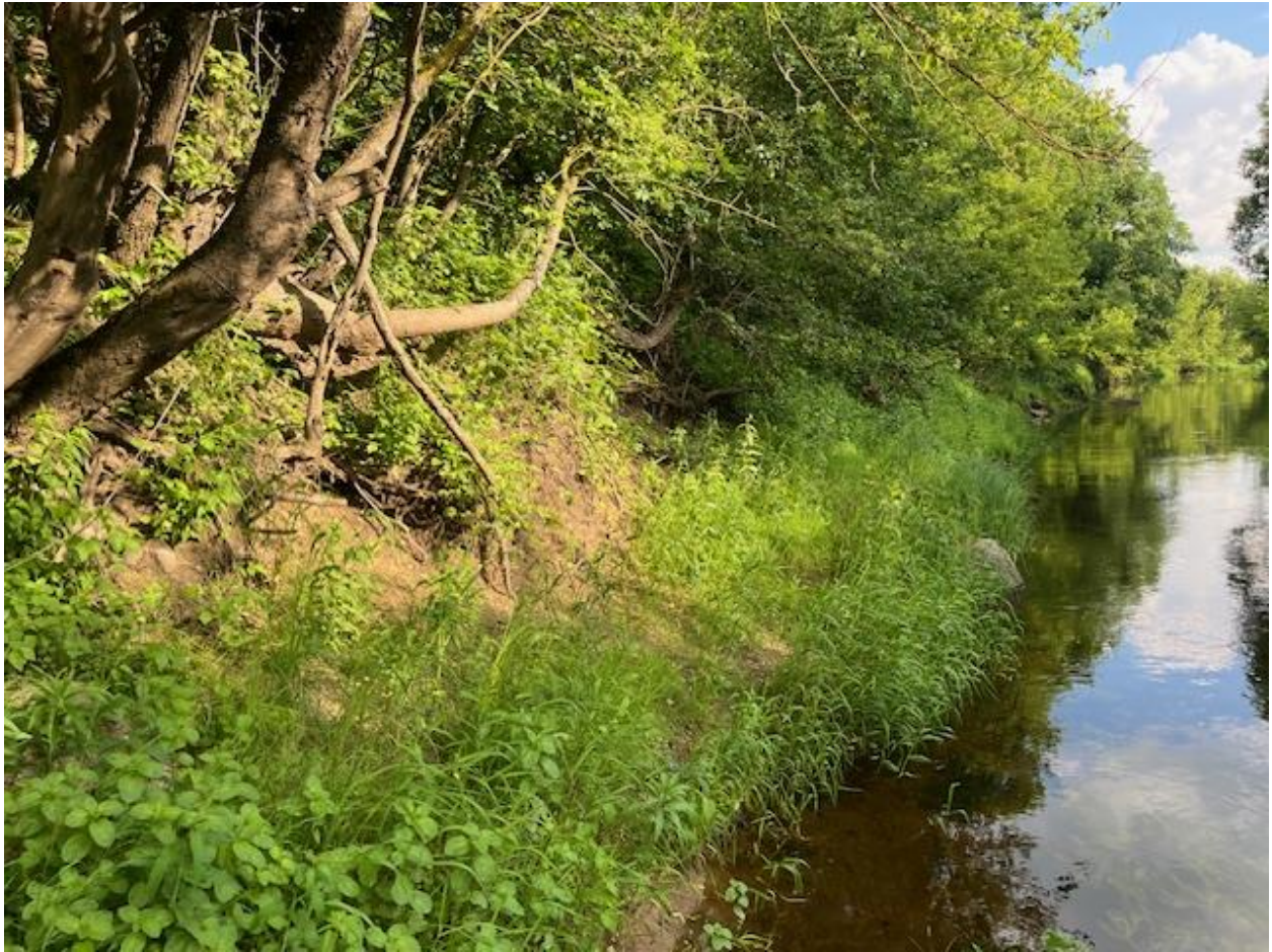
10 pav. Nevėžio upės ties Pk126,3 km kairiojo kranto išgrauža
