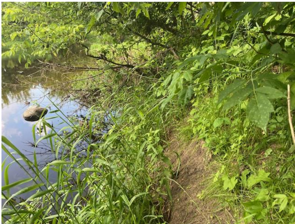
6 pav. Nevėžio upės ties Pk126 km kairysis šlaitas
