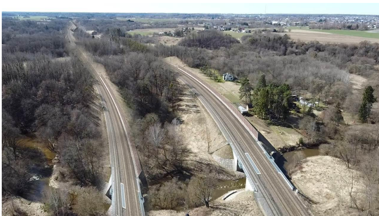
37 pav. Planuojama nauja 1,3 km ilgio geležinkelio vėžė ir tiltas Jiesios kraštovaizdžio draustinyje (40 pav. pažymėta 2 Nr.)
